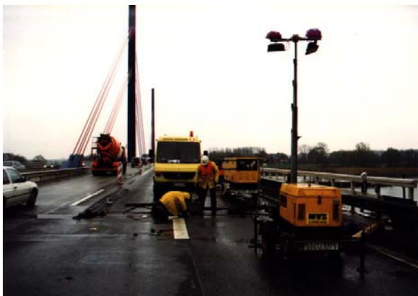
Ertüchtigung der Dehnfugen vom Typ DS480 der Norderelbbrücke i.Z.d. A1 bei Sperrung nur eines Fahrstreifens einer Richtungsfahrbahn je Bauabschnitt
