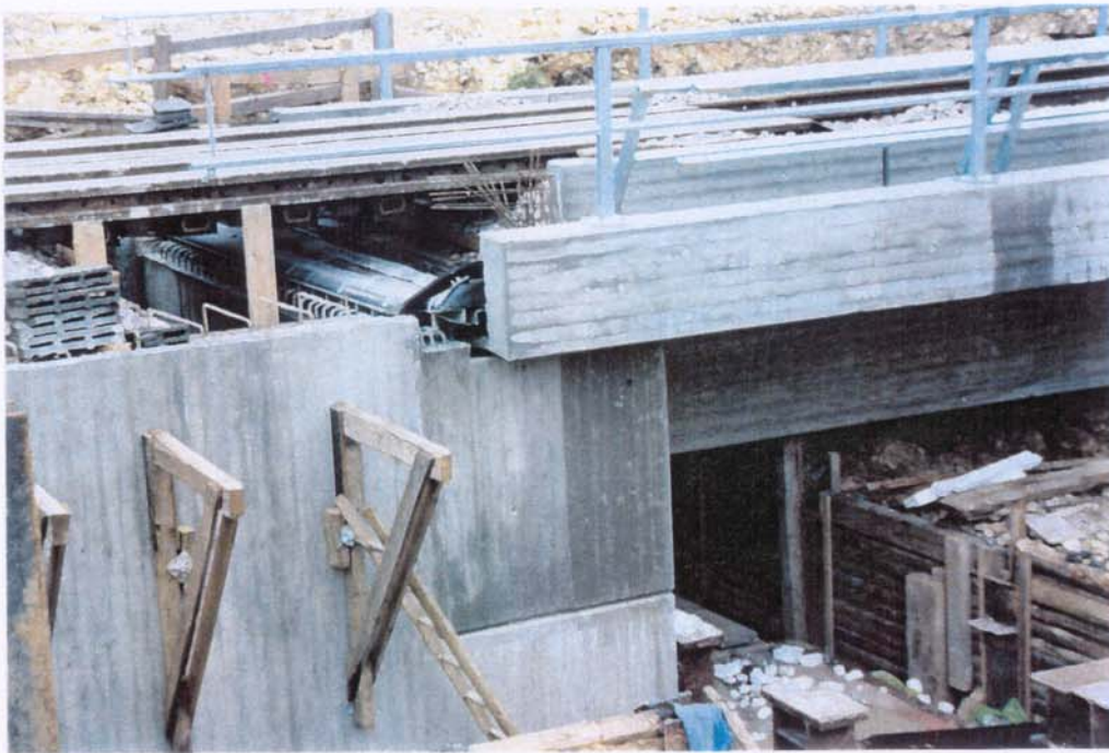
Widerlager Blaubeuren mit eingelegter Dehnfuge DB 130 Abutment 'Blaubeuren' with the expansion joint type DB 130 placed into.
