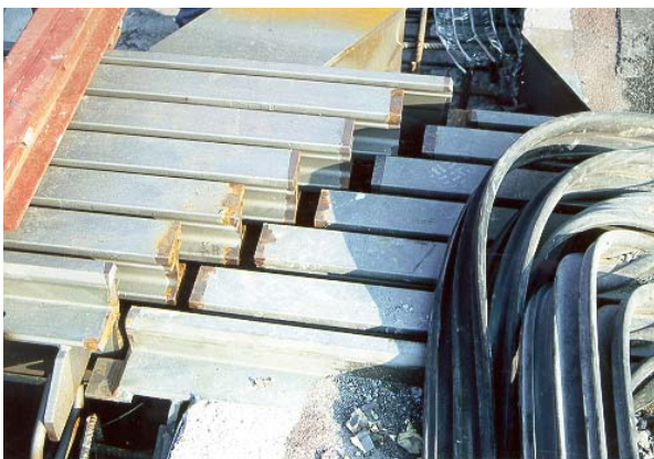
Wegen des Einbaus in Teilabschnitten mußten die Rand- und Mittelträger an der Baustelle miteinander verschweißt werden. Dies erfolgt nach einem von MAURER patentierten Schweißverfahren, dem sogenannten Kupferbackenstoß, der in ähnlicher Form auch beim bauseitigen Verschweißen von Eisenbahnschienen angewendet wird.
