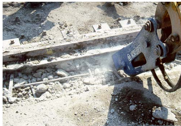
Die einbetonierten Randkonstruktionen wurden ausgestemmt. Widerlagerseitig war der Ausbau nicht zwingend erforderlich.
