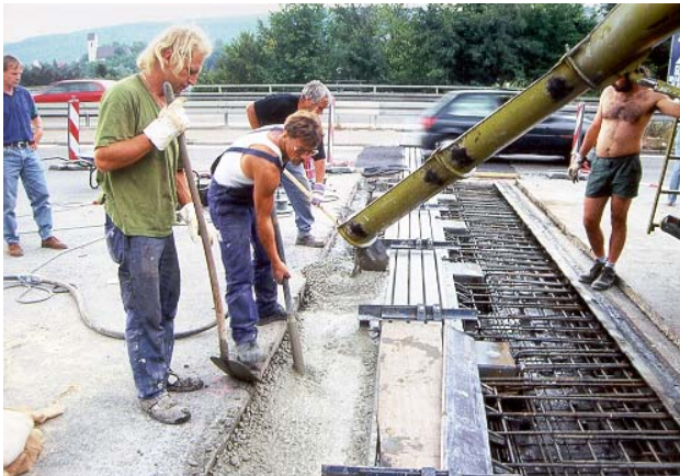
Nach Einbau der Schalung wird Beton der Güte B 35 eingegossen und durch Rütteln verdichtet.
