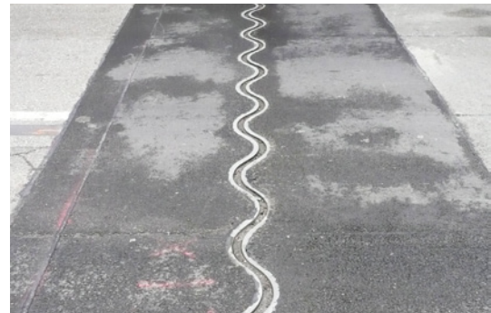
Die weltweit erstmalig eingebaute MAURER-XW1 Wellendehnfuge an der Donnersberger Brücke in München.
